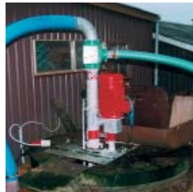
Farm B har kun en pumpe, som klarer både omrøring af fortanken, bagskyl i jordrør samt transport af gyllen til naboens gylletank.
