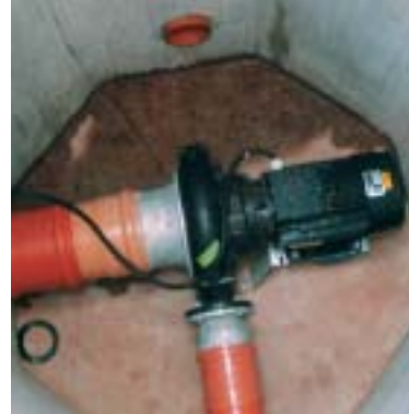
Tør opstillet pumpe i brønd
