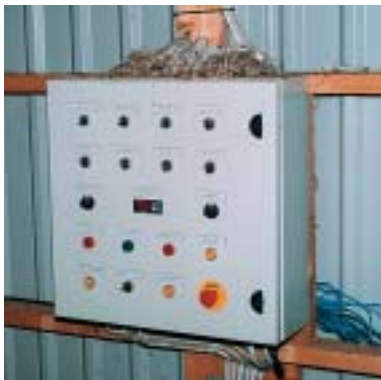
Styretavle med indbygget PLC.
