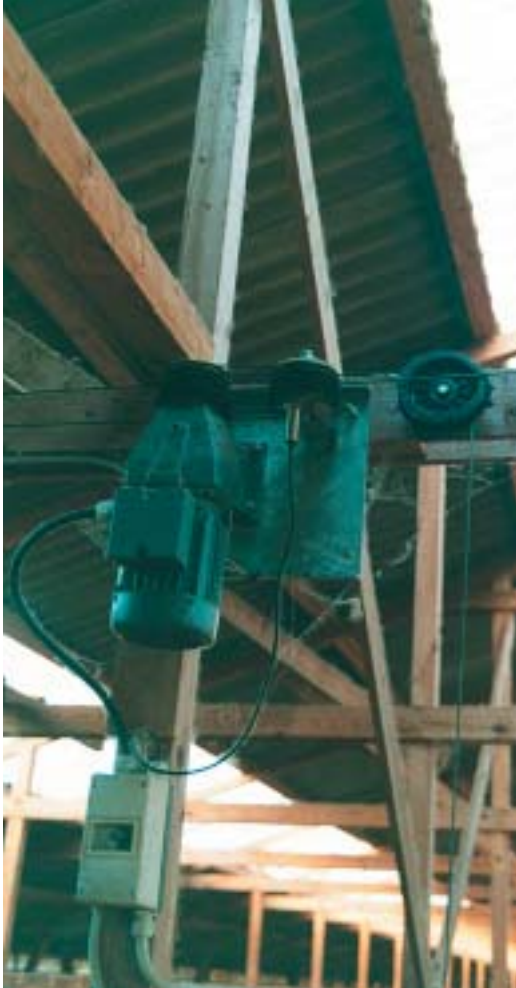
Trækstation til skraberanlægget. Bemærk den ekstra rulle med indbygget overbelastningsikring.
