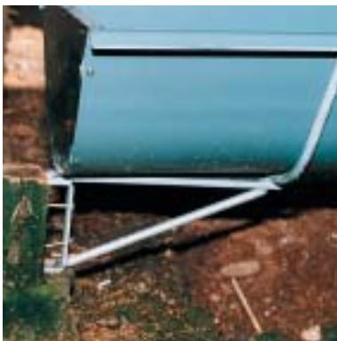
Bæringen i enden er udformet, så renden har mulighed for at udvide sig. Bemærk hvorledes endeproppen i renden er monteret (Farm B).
