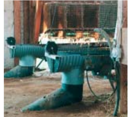
På farm B har man valgt skrå faldstammer for at undgå at komme i karambolage med vand- og elledninger, og for at kunne bevare så meget plads for enden af rækkerne som muligt. Bemærk at styrehjulene til wiren er med indstøbte kuglelejer.
