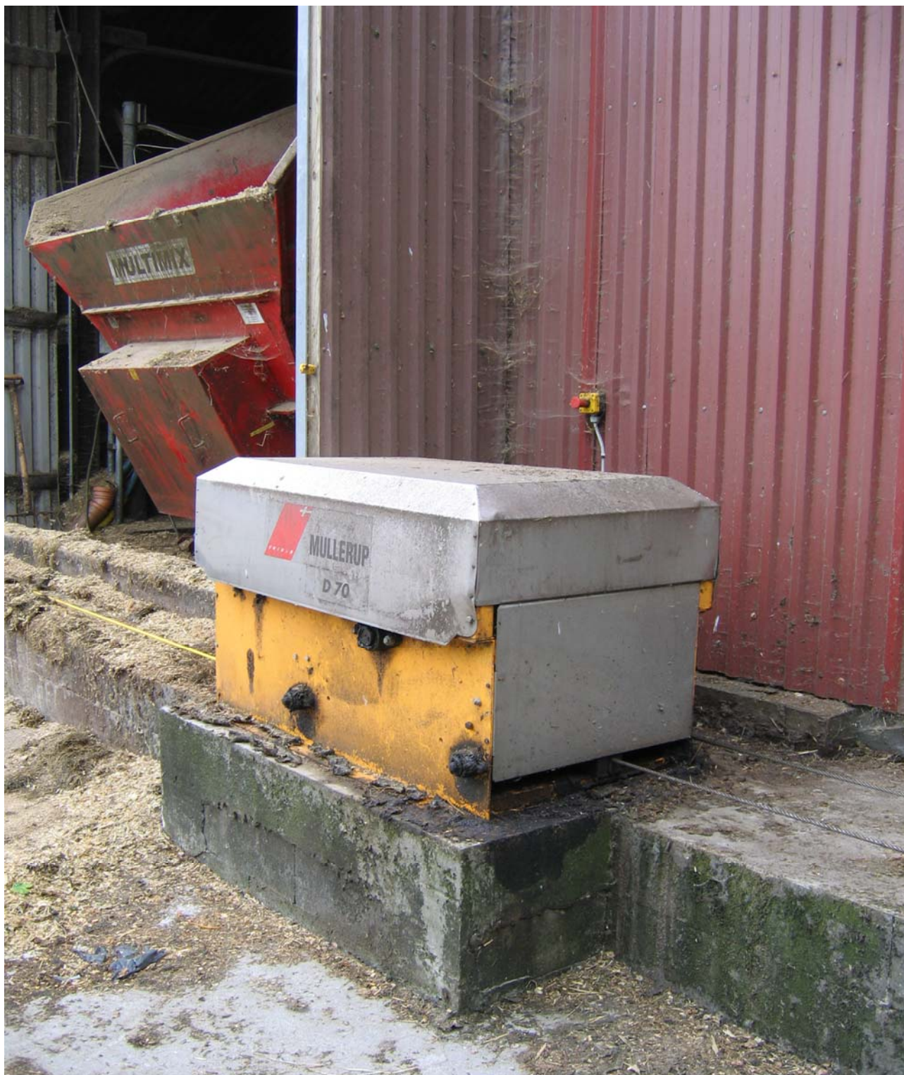
Billede 1. Trækstation med wiretræk placeret udendørs.
