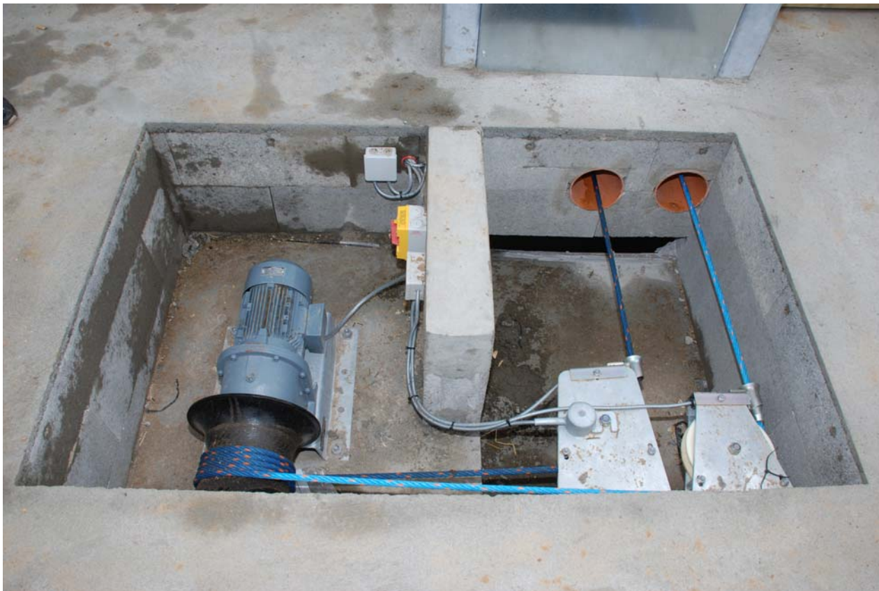
Billede 4. Nedsænket trækstation til kanalskraberen.
