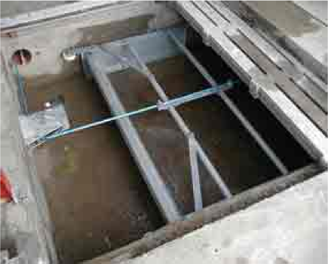
Billede 3. Skraber under spaltegulv.
